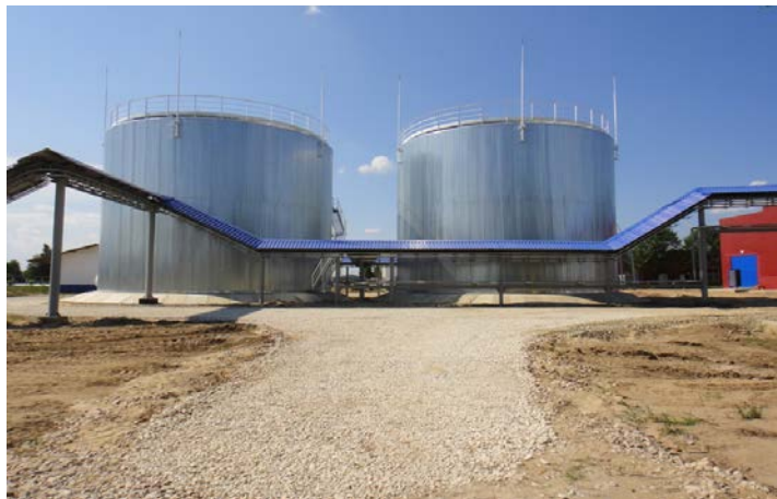
Слика 8. Резервоар са помичним кровом
