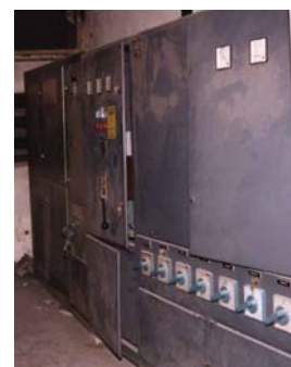
Слика 2. Изглед просторије у којој је смештен главни развод 0.4 kV
