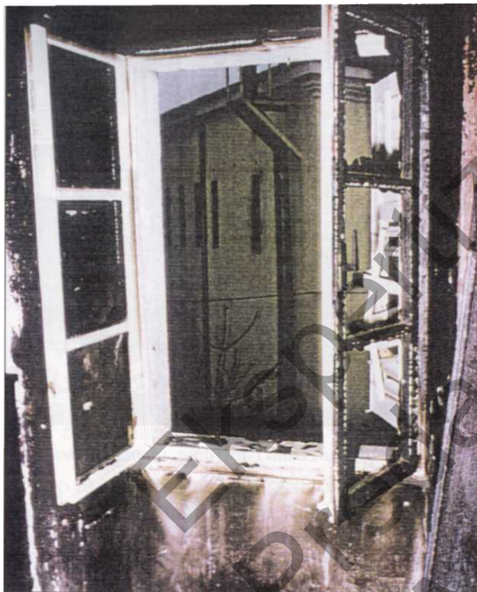
Priikaz tragova intenzivno oštećenog drvenog prozorskog okvira sa unutrašnje strane i ostataka termički oštećenog stakla
