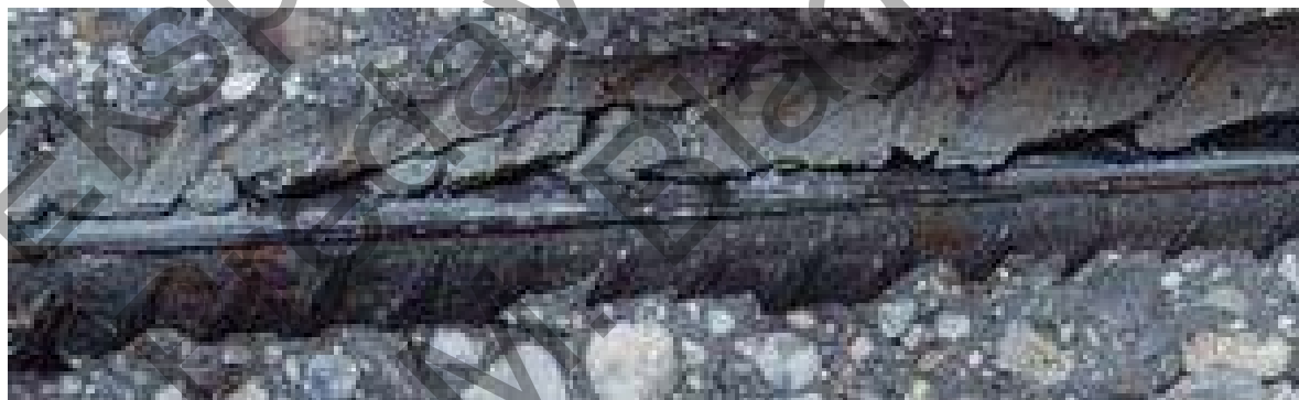
Tragovi na metalu kod armiranog betona
