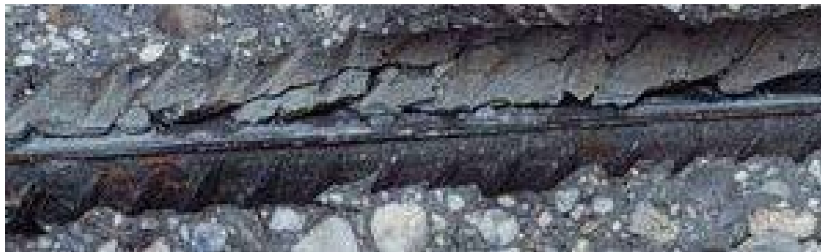
Tragovi na metalu kod armiranog betona
