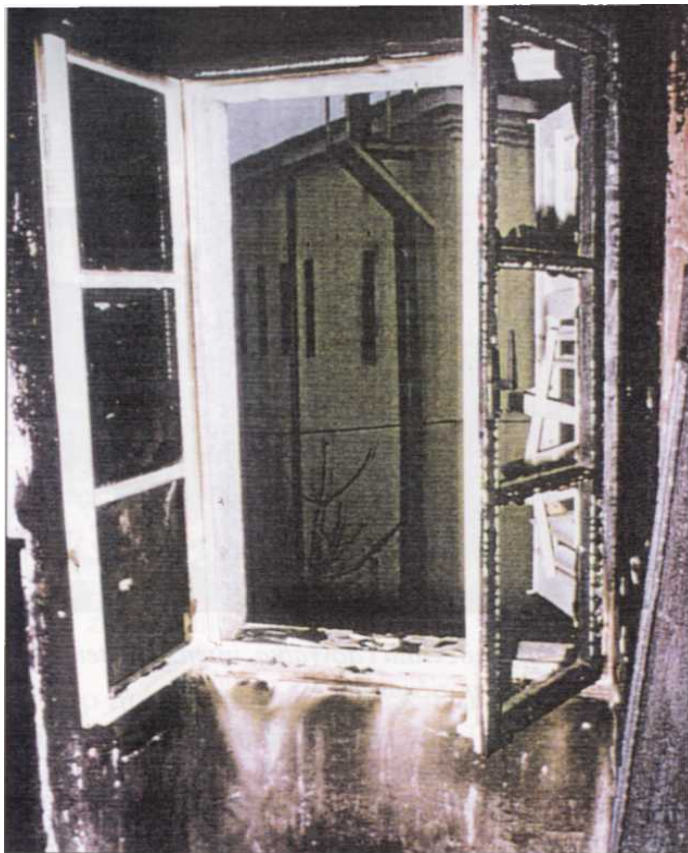
Priklad tragovala intenzivno oštećenog drvenog prozorskog okvira sa unutrašnje strane i ostataka termički oštećenog stakla
