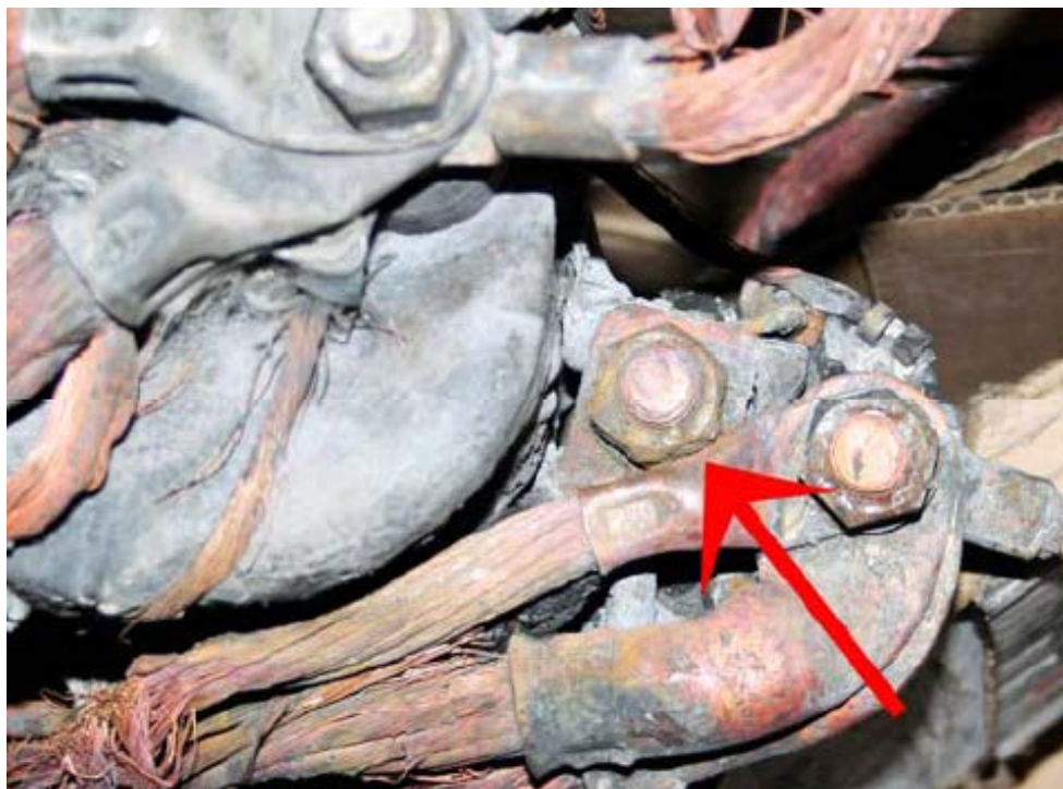
Kontakt između kablova
